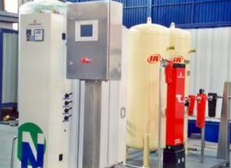
Générateurs de nitrogène
